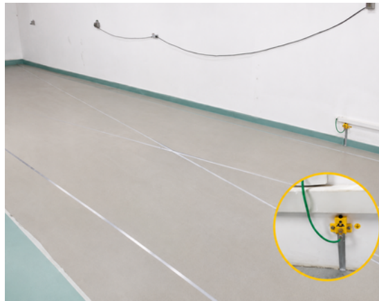
Malha de Aterramento
